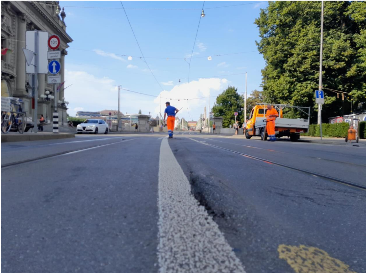
Durch die Hitze verformter Asphalt bei der Kornhausbrücke am 5. August 2022.
